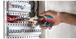
Habilitation Electrique BS
